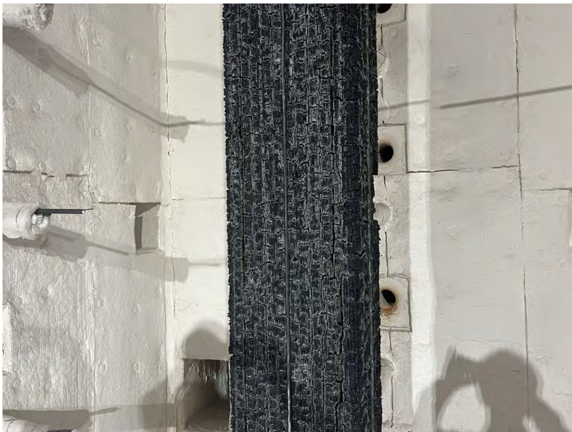
写真 4-11 脱炉後 右奥に脱落部分あり
