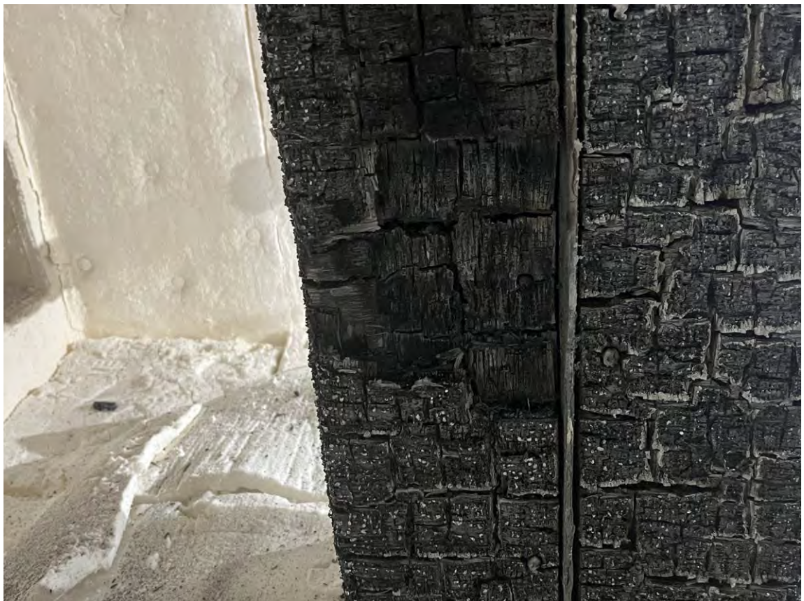
写真 4-14 被覆材が脱落した部位
