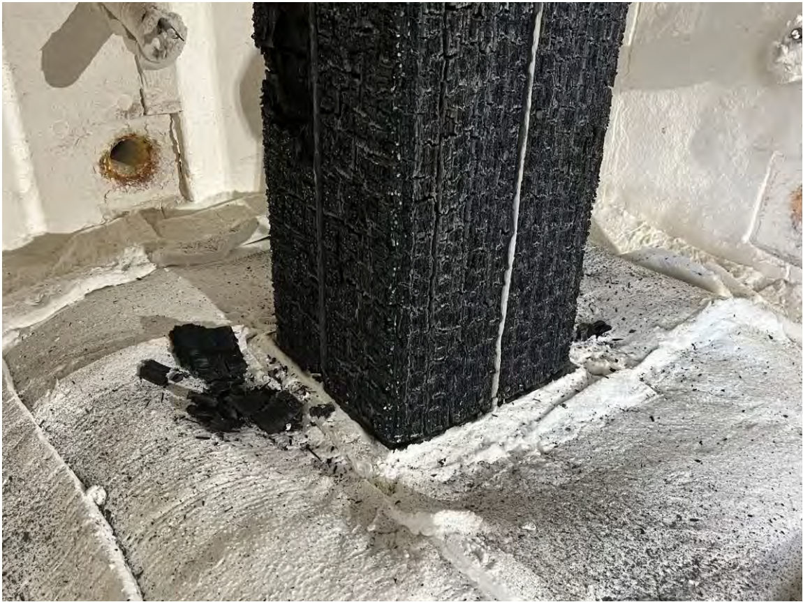
写真 4-13 脱落した被覆材
