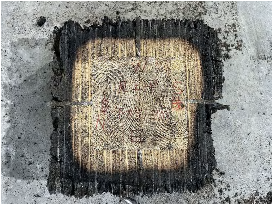
写真 4-24 断面（下から 1370mm 被覆材脱落部分）
