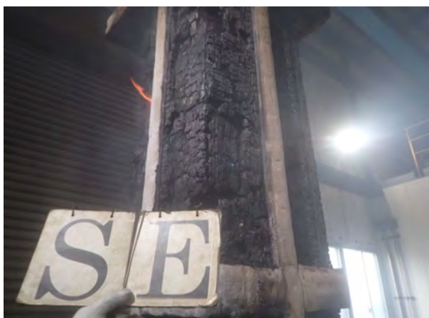
写真-9 試験体A 上半部SE面側 (加熱後)
