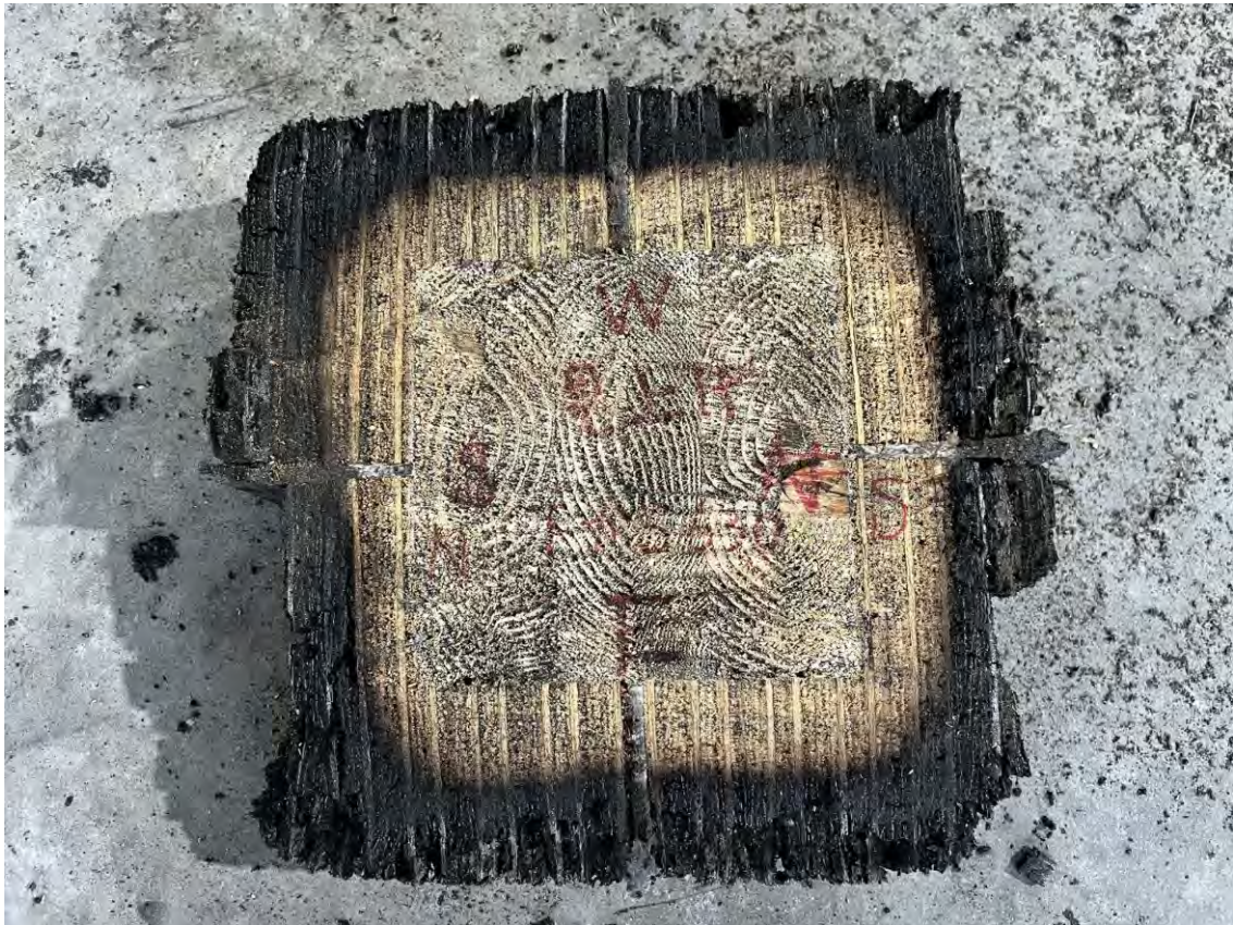
写真 4-23 断面（下から 630mm 被覆材脱落部分）
