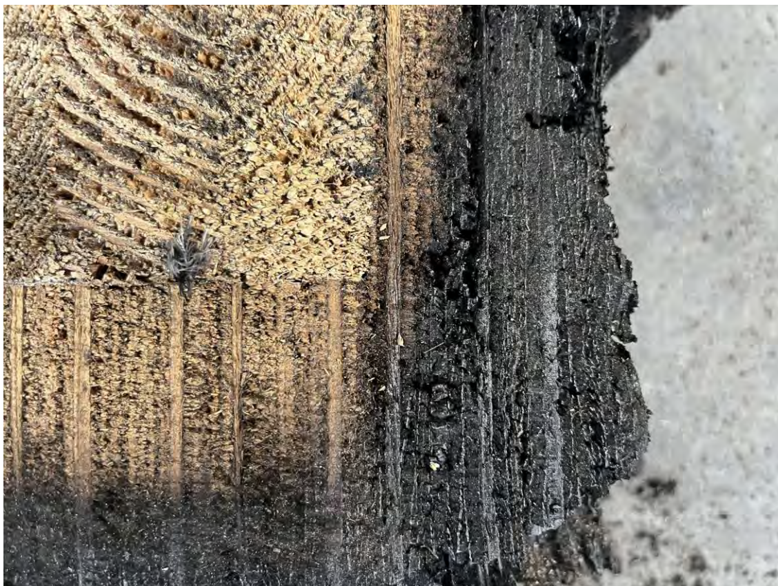
写真 4-25 断面（下から 1370mm 被覆材脱落部分側 黒色化が一番大きかった）
