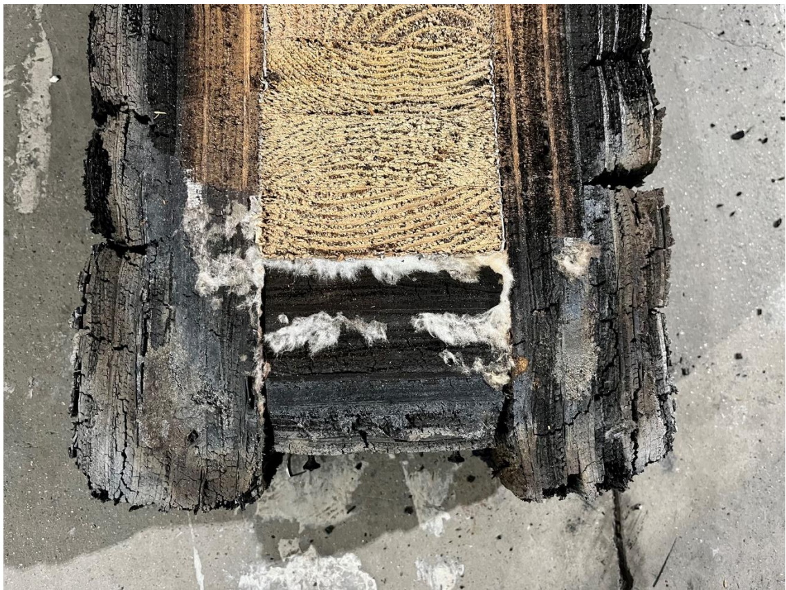
写真 3-4-22 被覆材炭化部（中央部）
