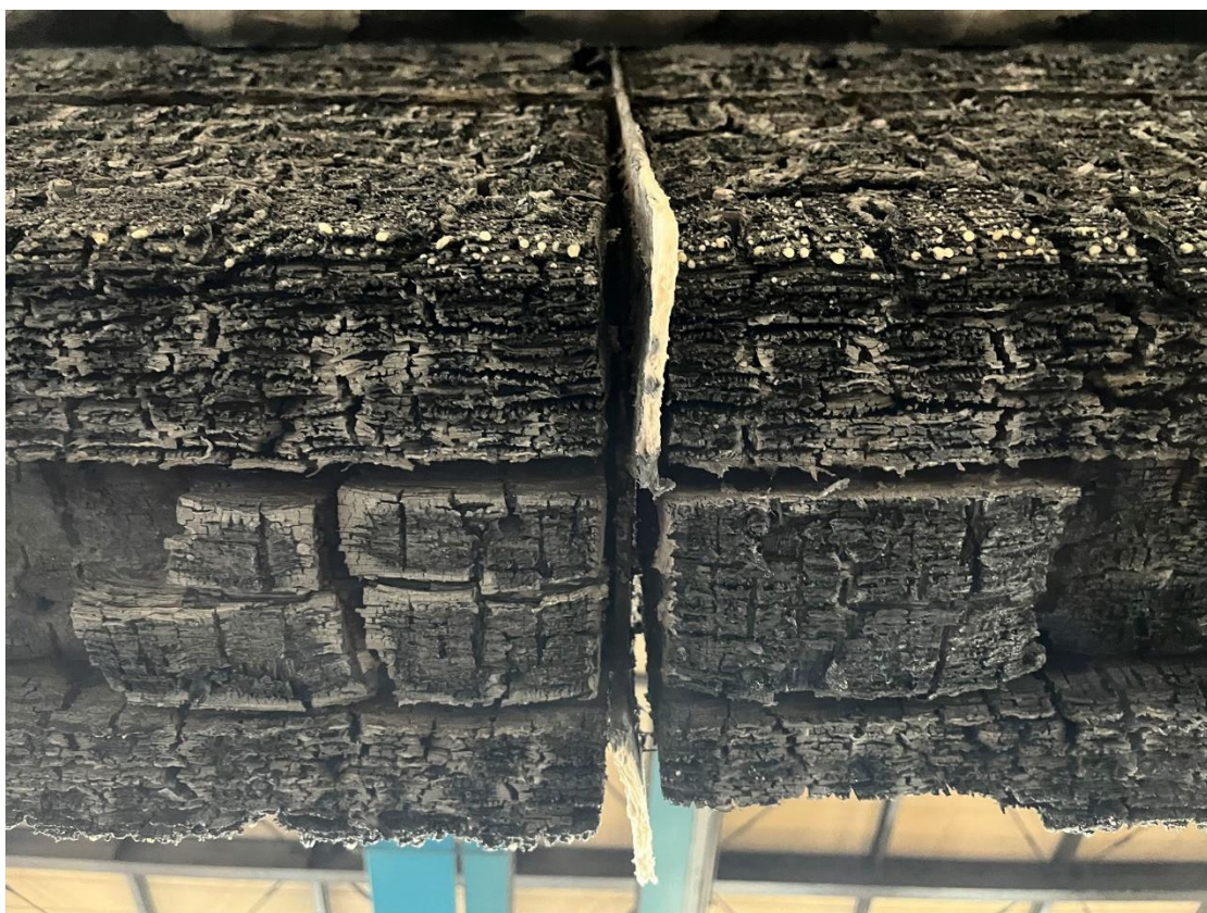
写真 3-3-23 試験体底面（目地部中央）
