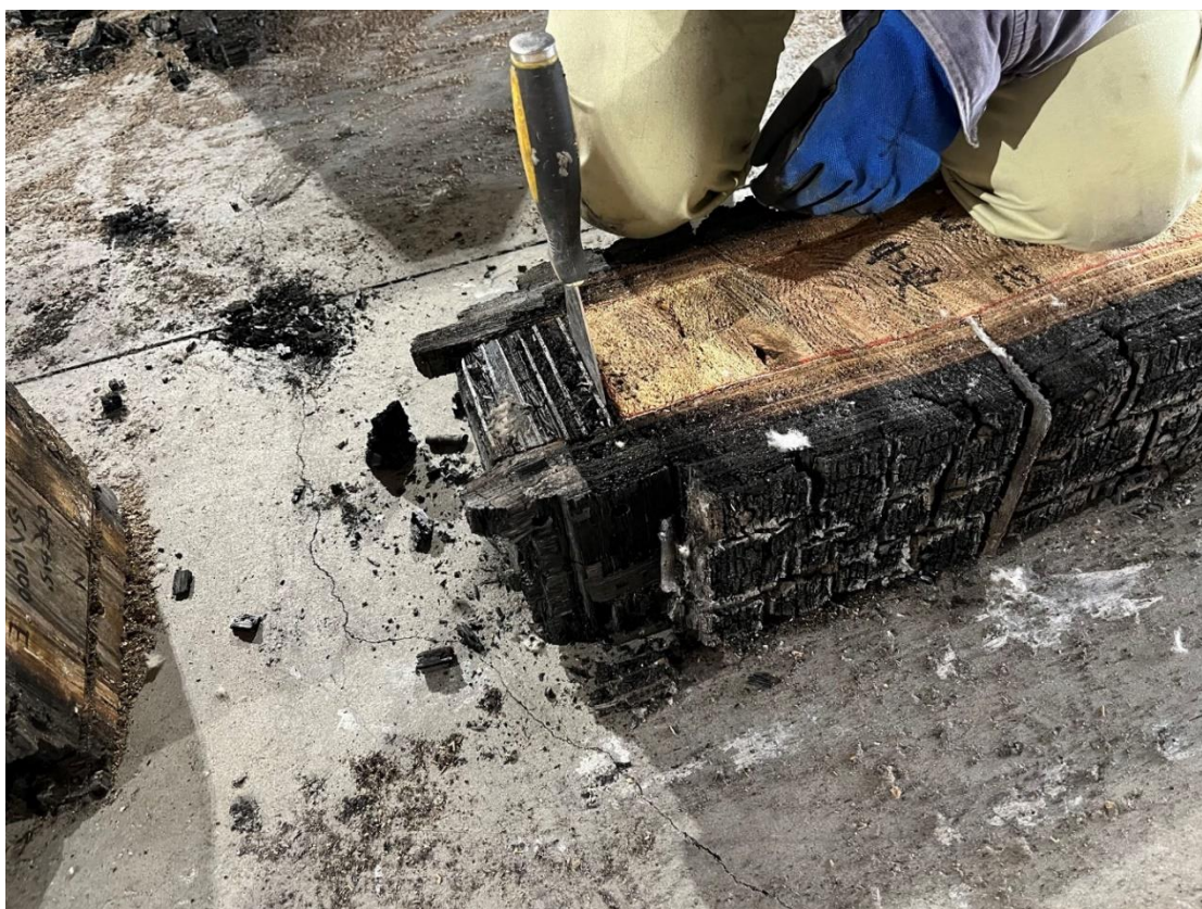
写真 3-3-37 荷重支持部の炭化確認（中央部）
