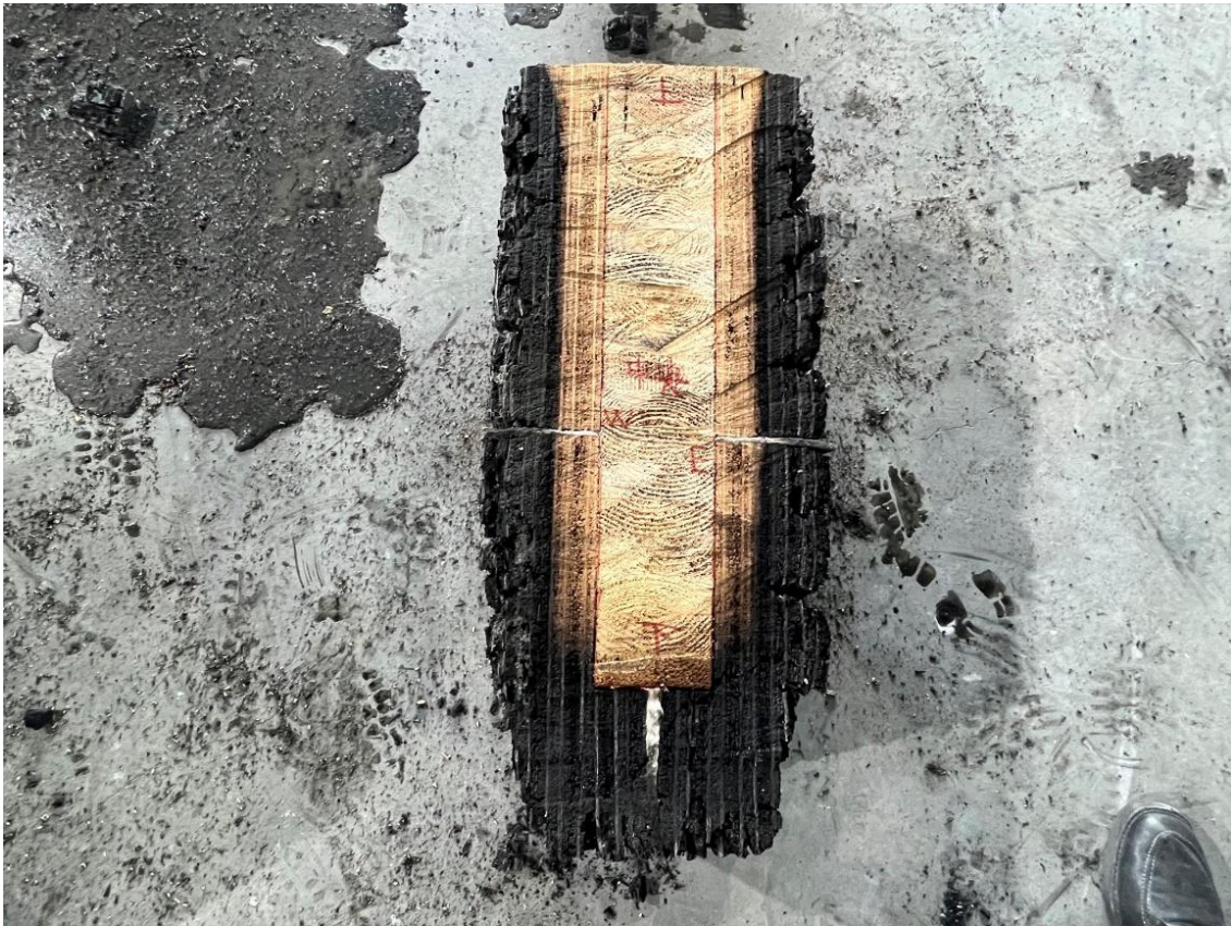
写真 3-5-23 被覆材炭化部（中央部）
