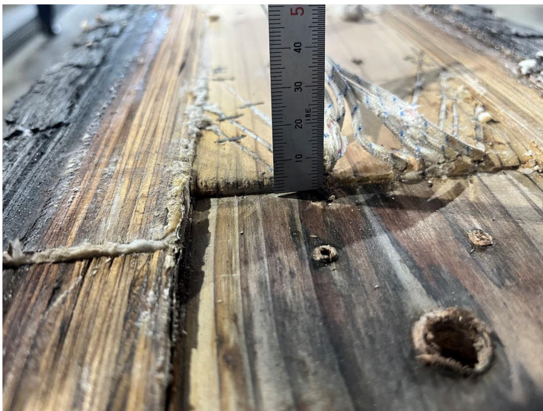
写真 3-3-27 荷重支持部のめり込み状況
