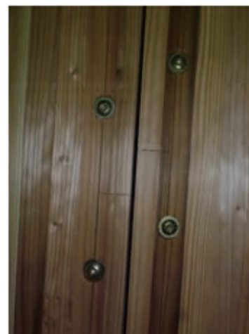
パネル継ぎ手部分のずれも大きい
