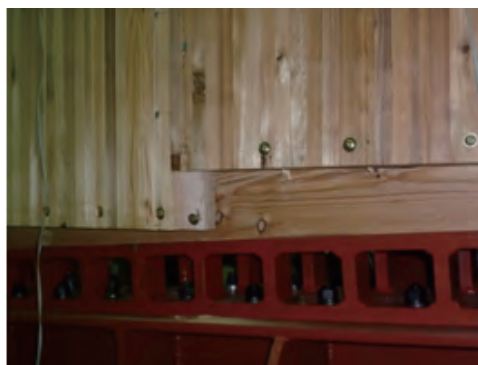
斜め打ちのビスは破断したのも多く見られた
