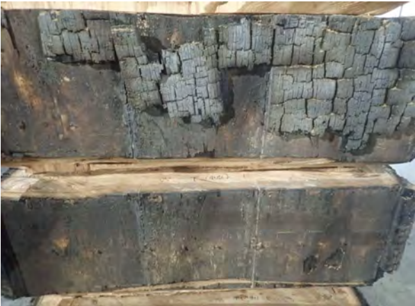
写真-33 試験体B 下面(中央) (解体後)
