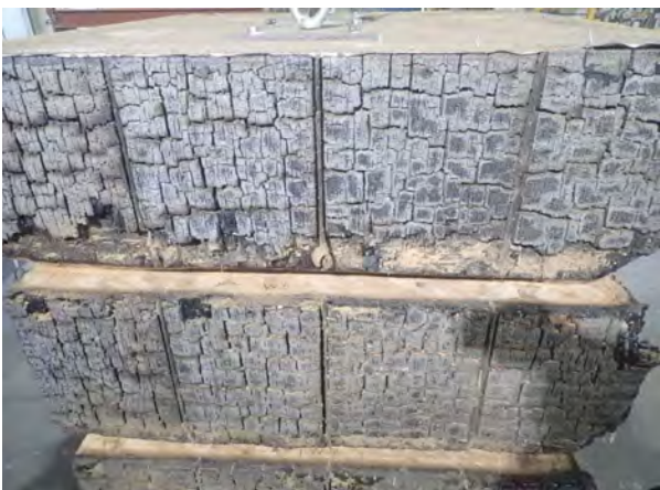
写真-29 試験体B W面(S側) (解体後)
