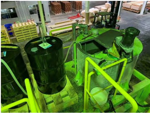
写真 3.1.3 難燃薬剤と薬剤タンク
