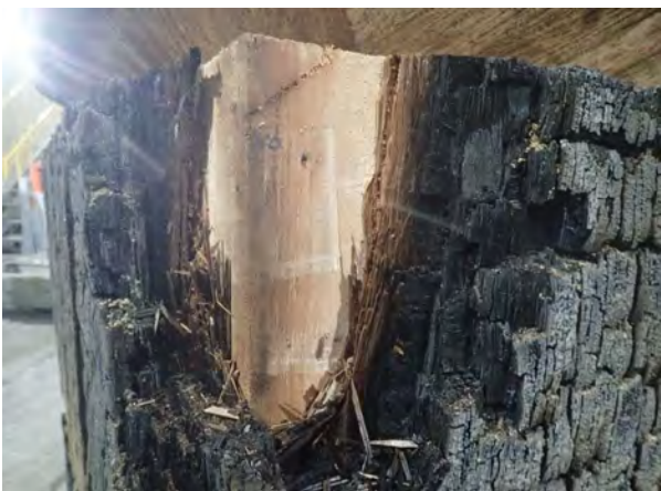
写真-17 試験体A W側角部 (解体後)
