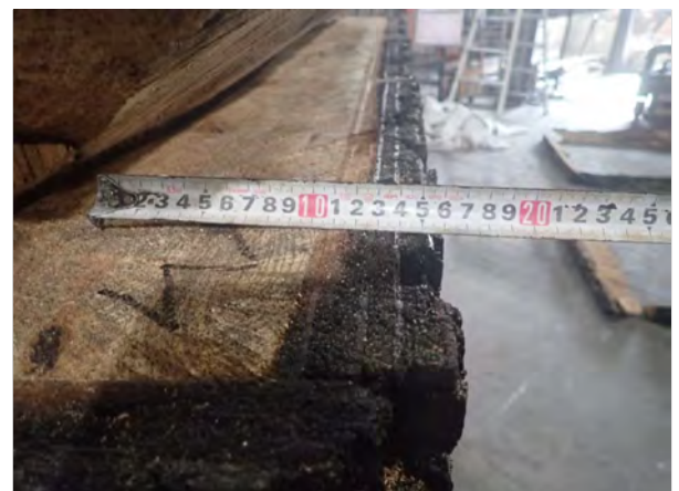
写真-18 試験体A W側角部 (解体後)
