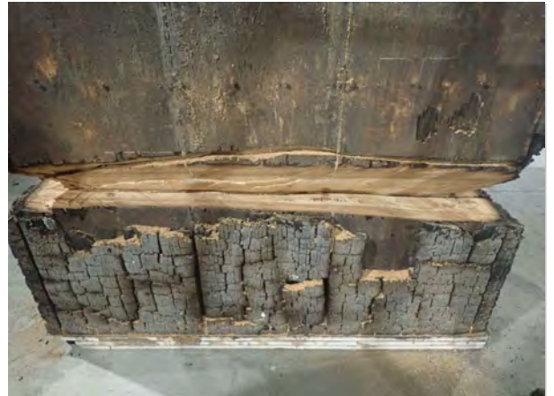
写真-34 試験体B 下面(N側) (解体後)
