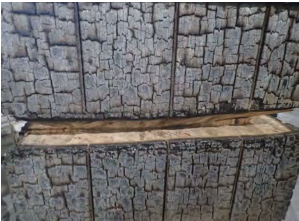
写真-9 試験体A NW面側(上段) (解体後)
