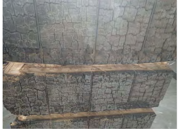
写真-26 試験体B E面(S側) (解体後)
