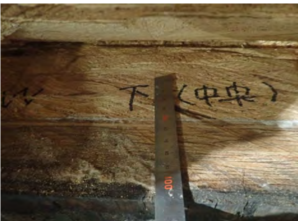
写真-35 試験体B 下側平部 (解体後)
