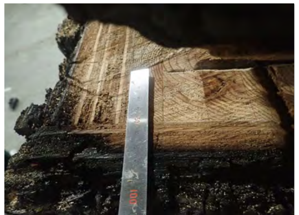
写真-36 試験体B E側角部 (解体後)
