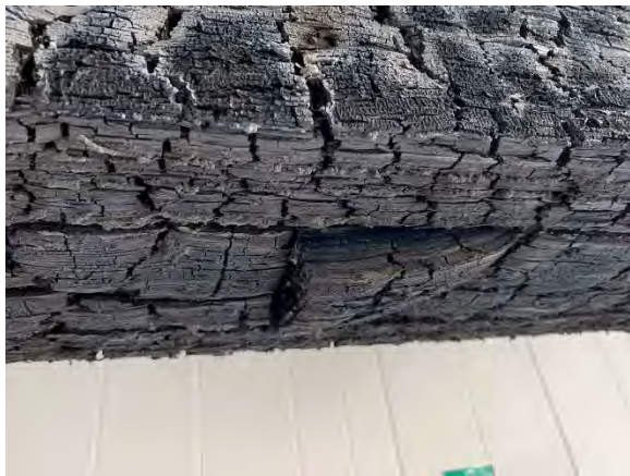
写真 4-23 下面被覆材剥がれ
