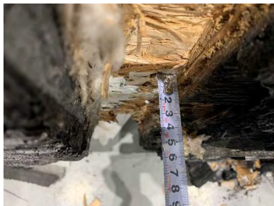
写真 4-37 被覆材で健全部は 20mm ほど
