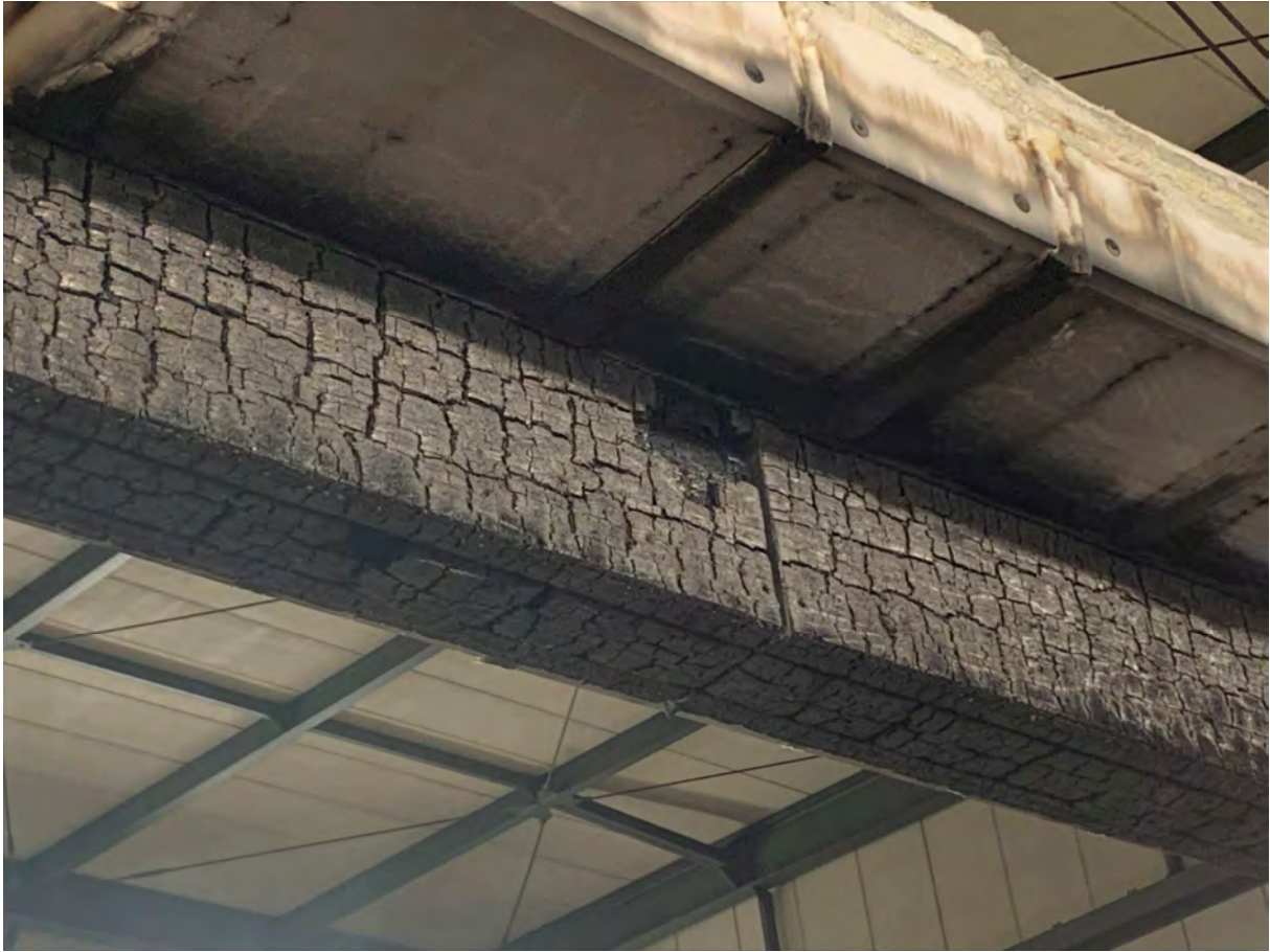
写真 4-9 側面の脱落 西側
