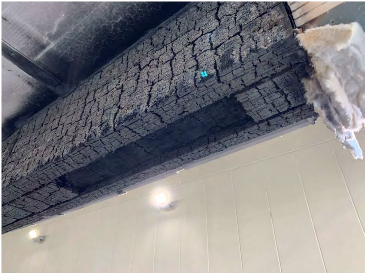
写真 4-7 北側下面 30mm 被覆材脱落
