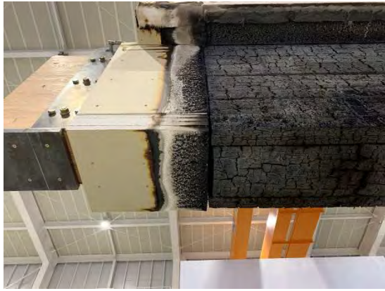
写真 4-22 被覆材と石膏ボード境界（北側）
