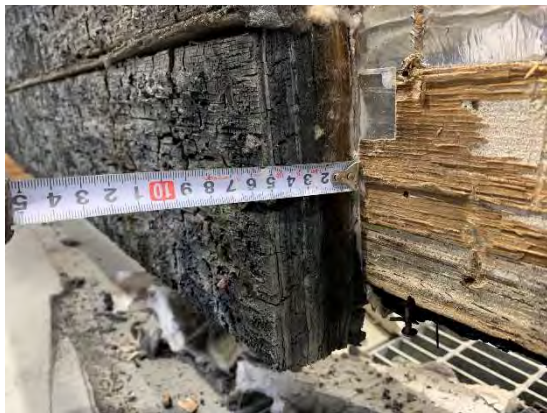
写真 4-50 梁下部隅部（西側中間点）
