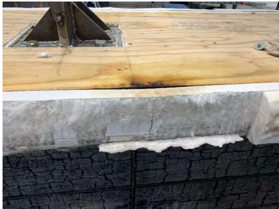
写真 4-24 床合板の炭化（南西側 1/4 点）
