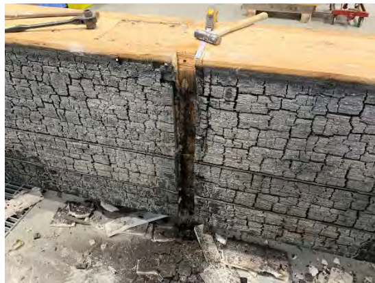
写真 4-35 被覆材目地部はがし (南西側 1/4 点)
