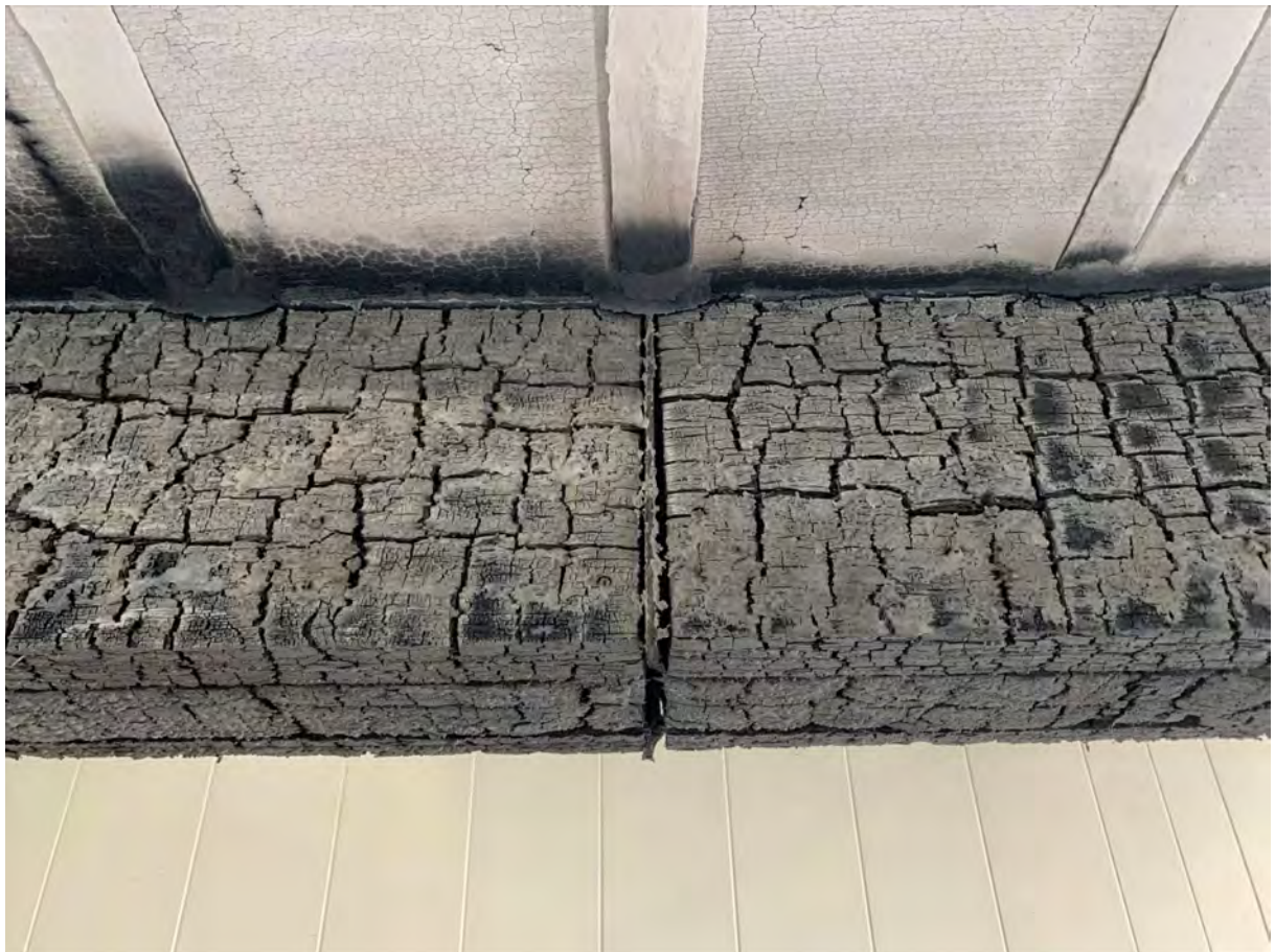
写真 4-9 側面 北側中間点目地
