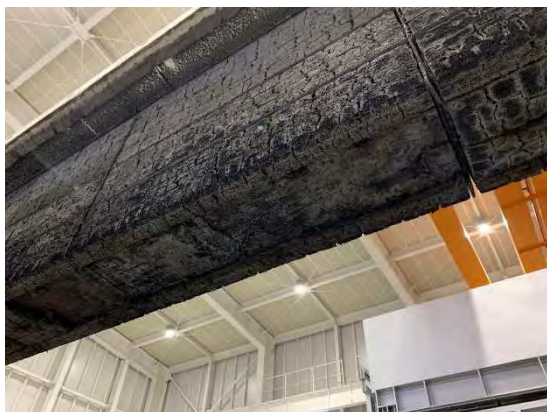
写真 4-20 被覆材下面（中間点北側）58分に脱落
