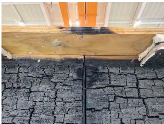
写真 4-28 合板下面と被覆材（南西側 1/4 点）
