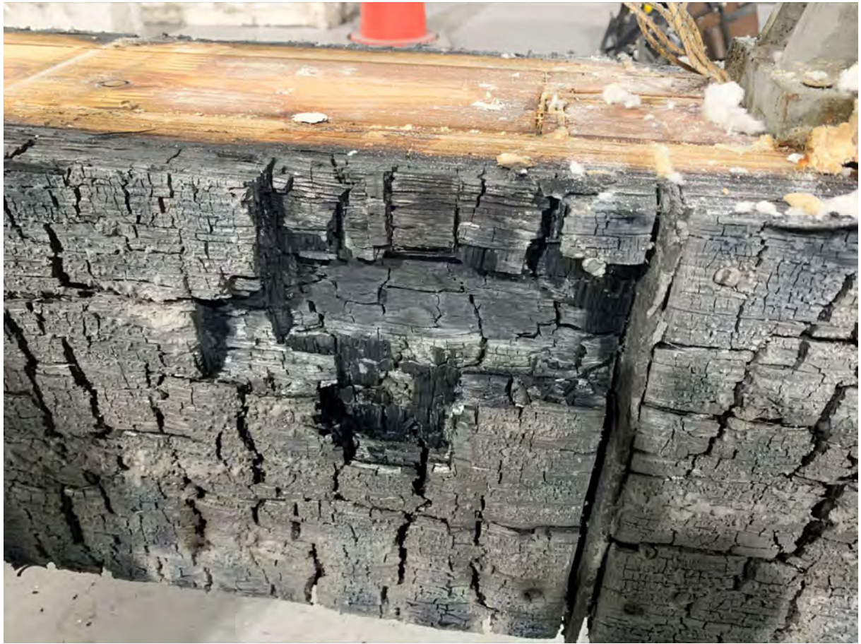
写真 4-15 被覆材脱落部
