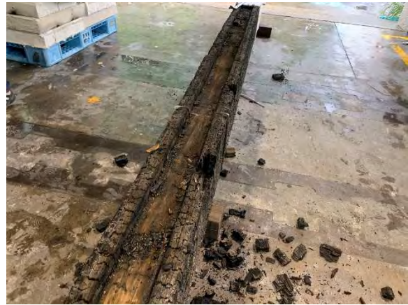
写真 4-24 下面 30mm 被覆を剥がした
