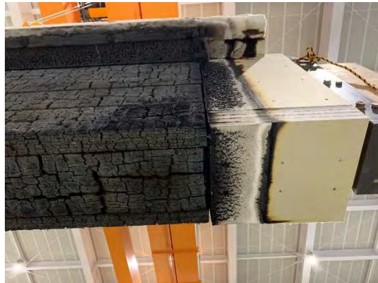
写真 4-17 被覆材と石膏ボード境界（南側）
