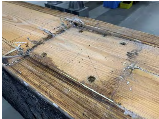
写真 4-53 加力治具の梁へのめりこみ（南）
