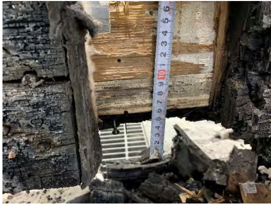
写真 4-46 梁下部隅部（西側中間点）
