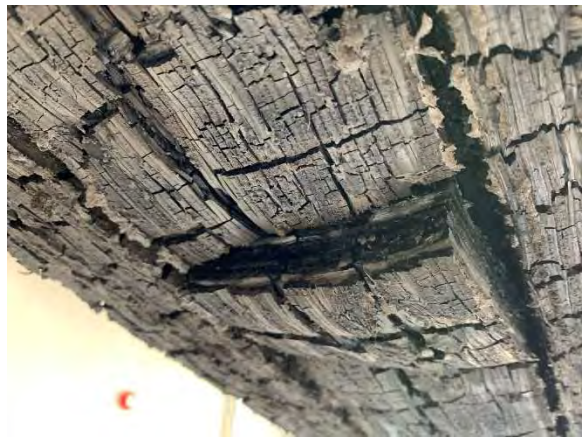
写真 4-24 下面被覆材剥がれ
