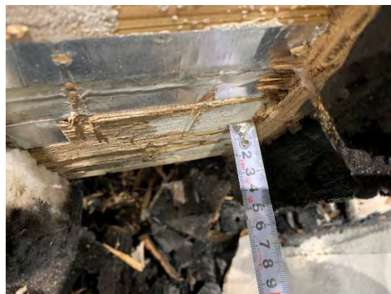
写真 4-45 被覆材で健全部は 20mm ほど
