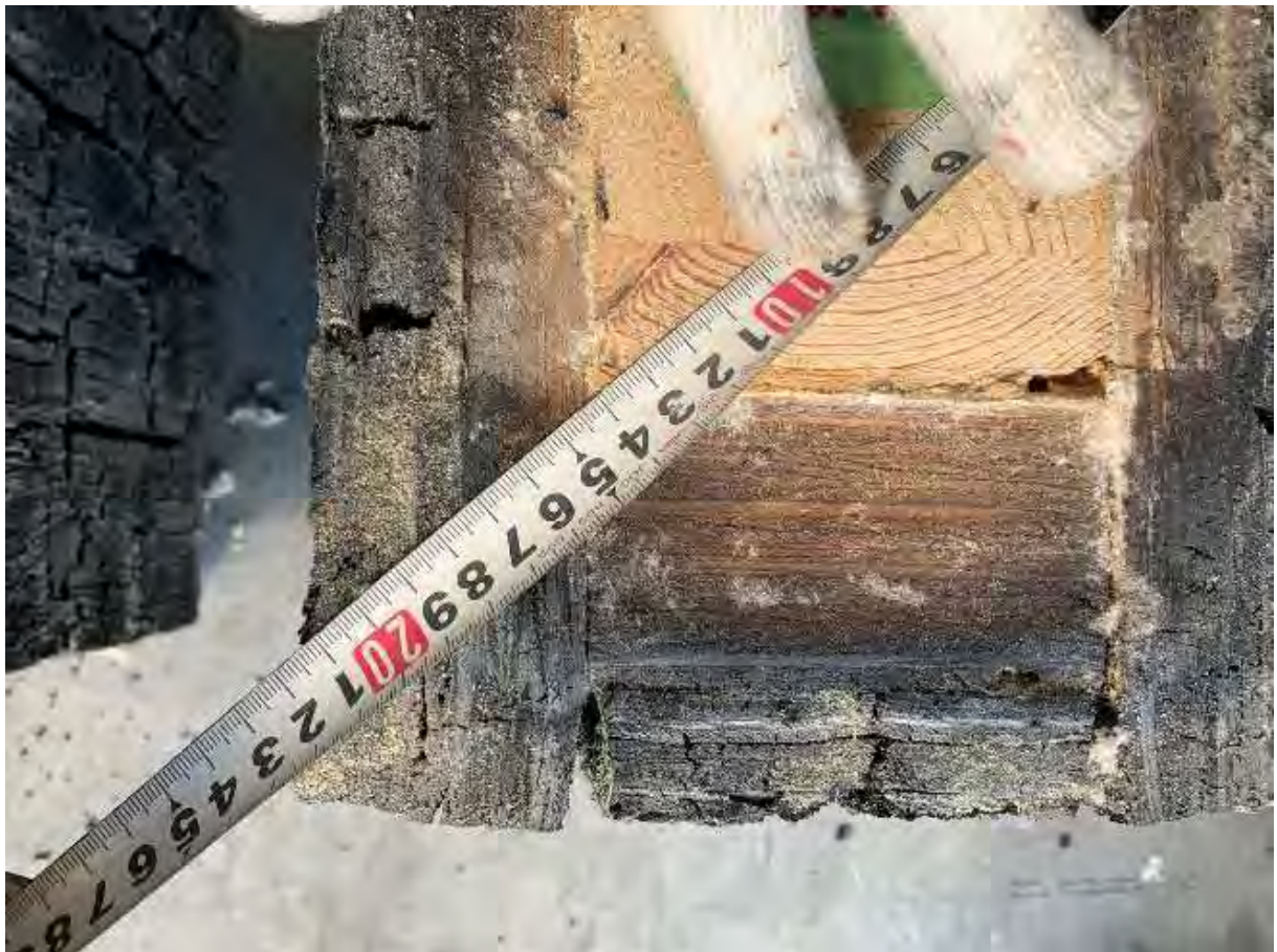
写真 4-36 被覆材下部の炭化は梁隅部まで残り 10mm 程度
