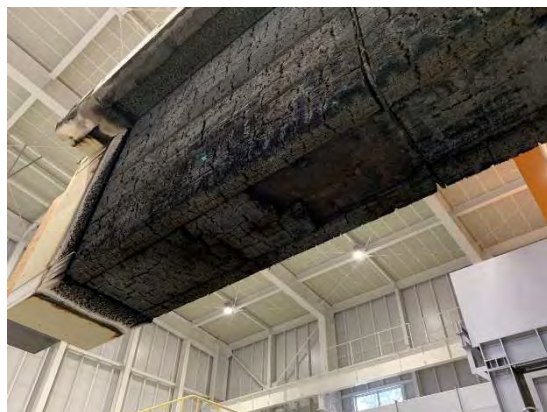
写真 4-21 被覆材下面（側端）脱落
