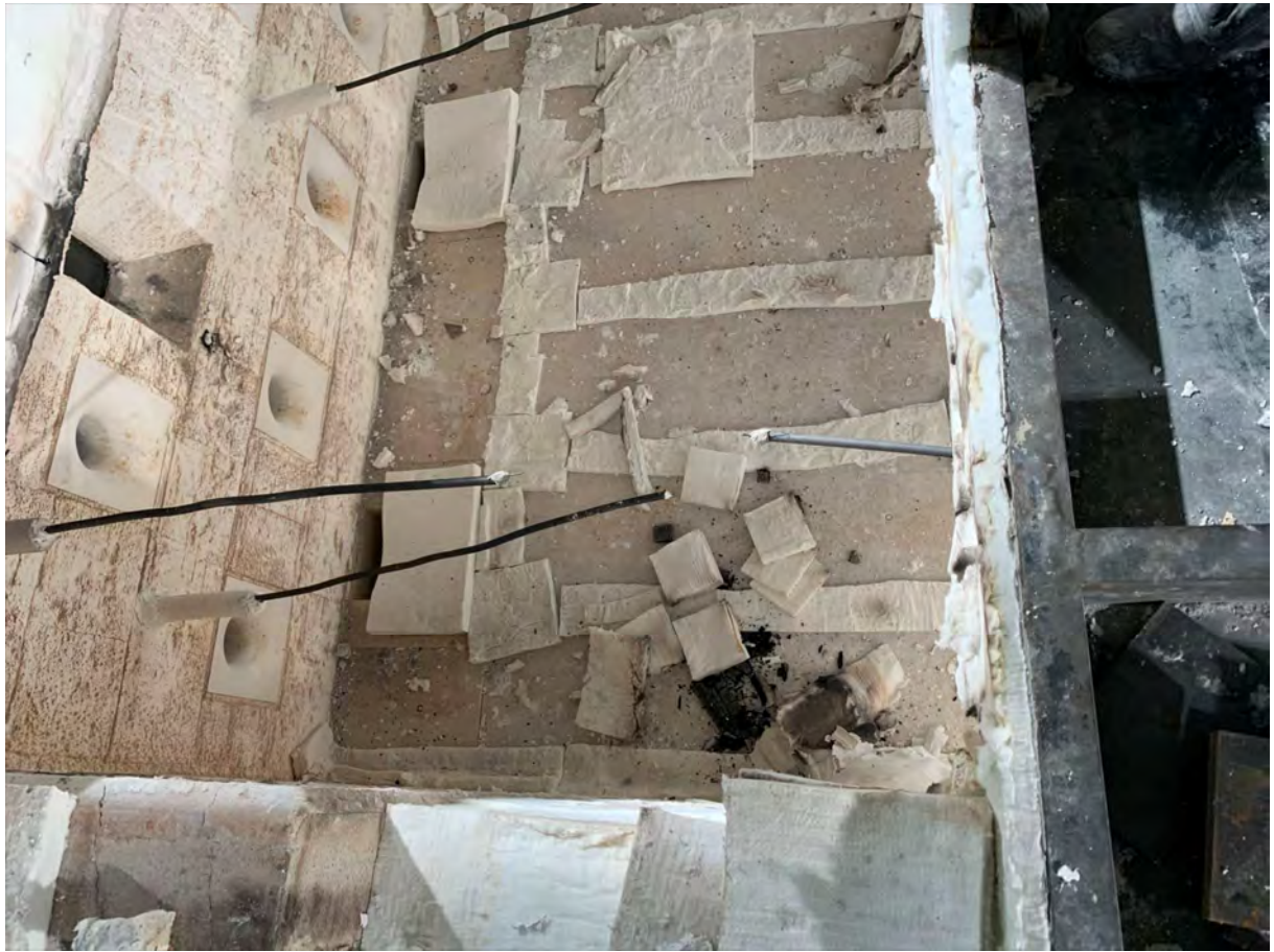
写真 4-12 脱炉後の炉内 脱落した被覆材
