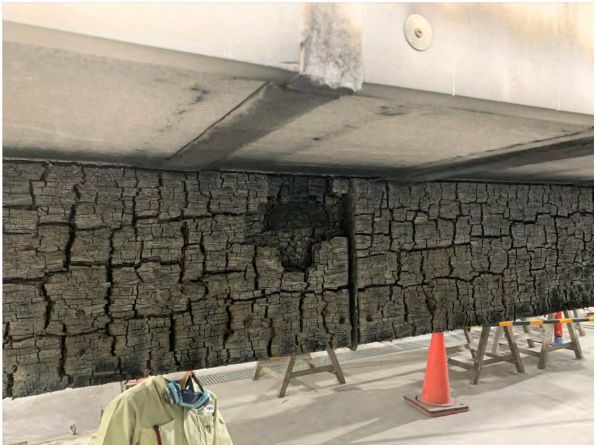
写真 4-12 側面の脱落 西側
