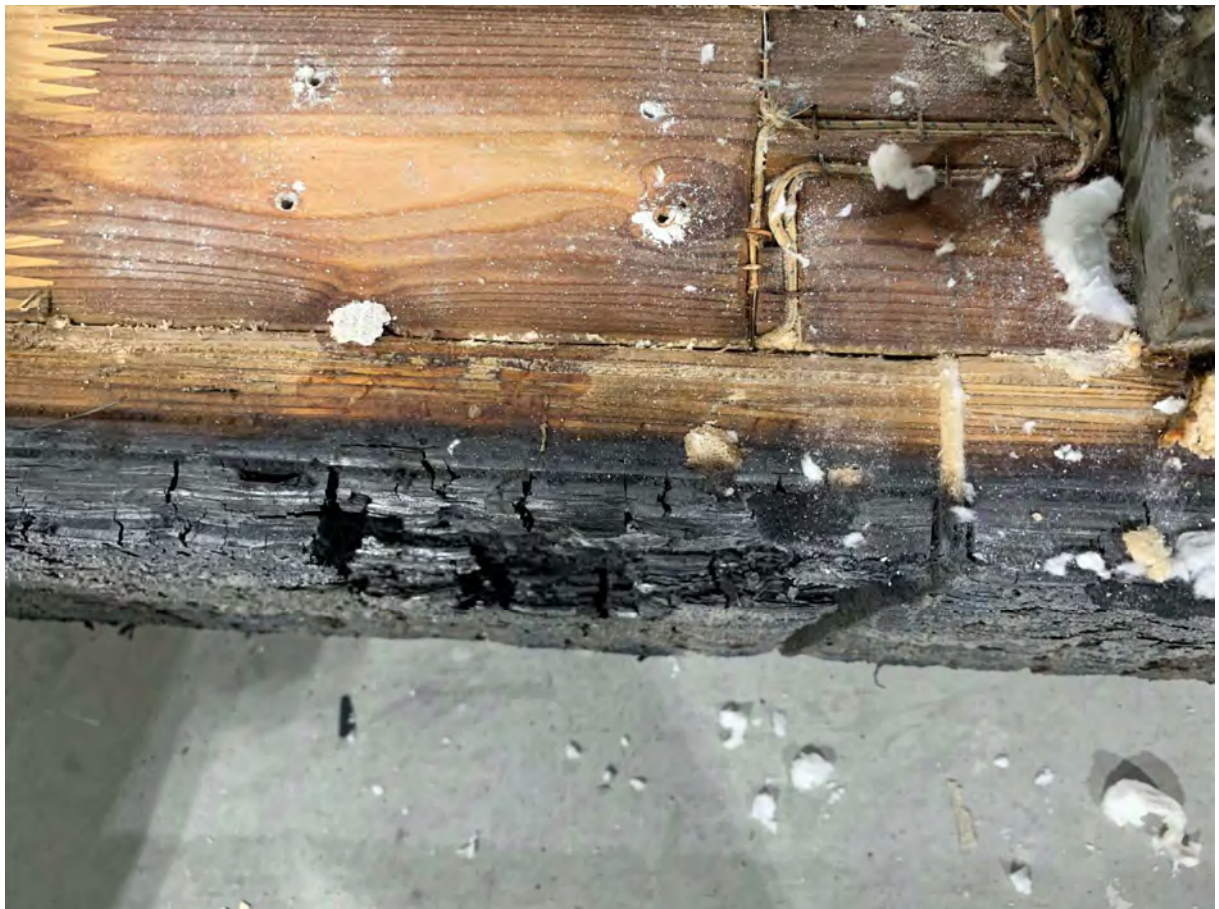
写真 4-16 脱落部の被覆材炭化具合は他と変わらない
