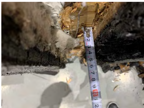
写真 4-36 被覆材で健全部は 20mm ほど
