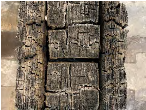
写真 4-23 下面 突きつけ部
