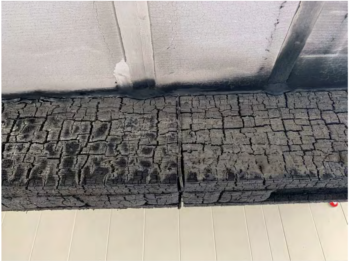
写真 4-8 側面 北東 目地
