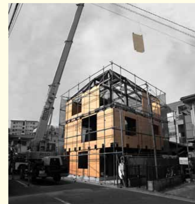
現場写真モンタージュ：クレーンでパネルを吊り上げ、鉄骨軸組に取り付ける。
