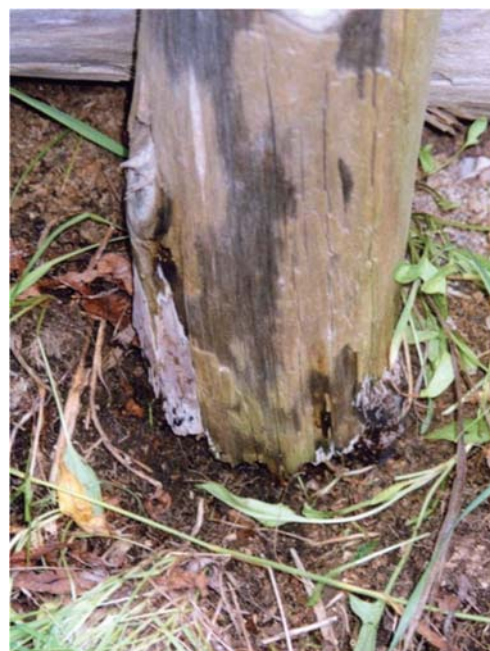
写真 4-⑤-3 地際部分の腐朽
