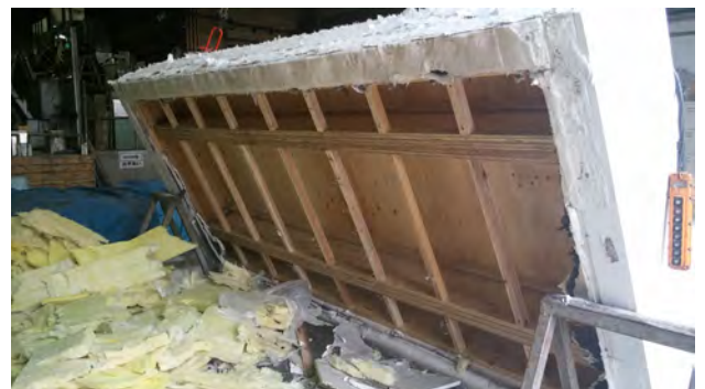
写真 7-3. 床躯体の中に火が回って炭化していないかを確認する。
