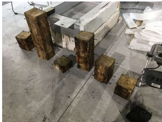
写真 4.3.1.17 被覆材を剥がした柱
