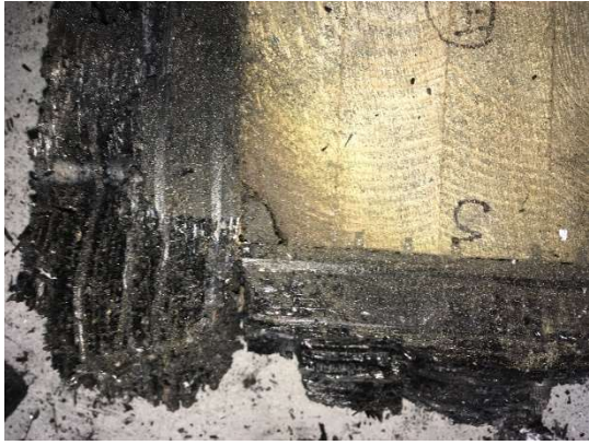
写真 4.3.1.20 最下部隅部 柱の欠け
