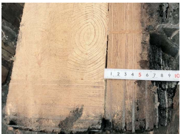
写真 4.2.1.13 エプトシーラーによる隙 間
