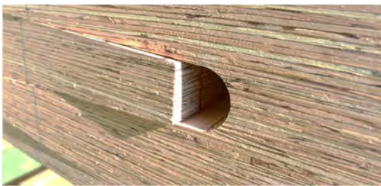
(iii) 木口の割裂
