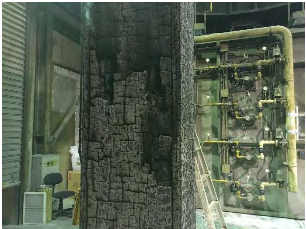
写真 4.2.2.3-10 西側燃え止り層の脱落
