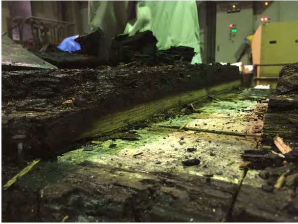
写真 4.2.2.3-13 炭化が進んでない断面
