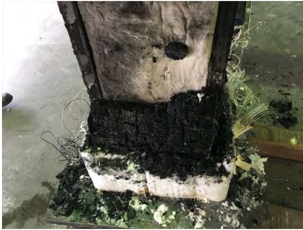
写真 4.4.2.3-7 燃えカスになっている単板積層材材
