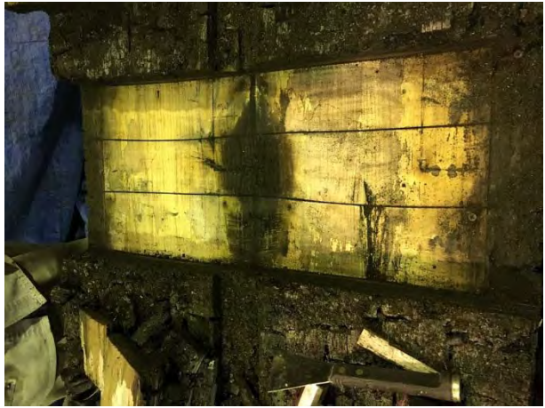
写真 4.2.3.3-8 北側上部の炭化様子
