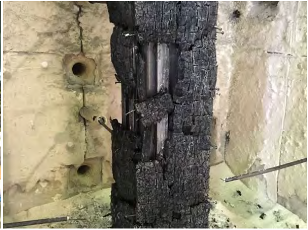
写真 4.4.1.3-10 柱下部の燃えぬけ
