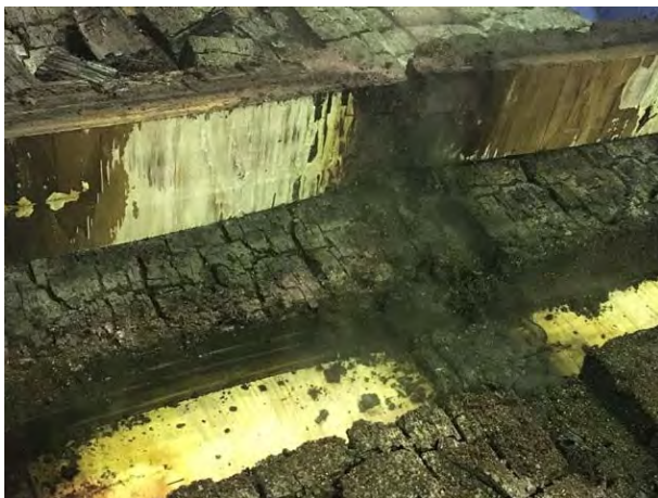
写真 4.2.3.3-11 北側上部の炭化状況
