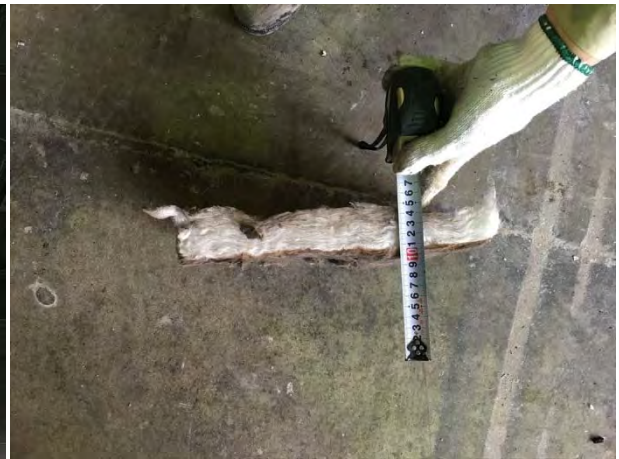
写真 4.4.2.3-10 断熱材の膨らみ状況
