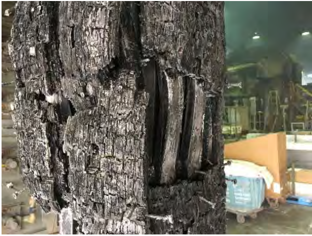
写真 4.4.1.3-9 柱中間部座屈
