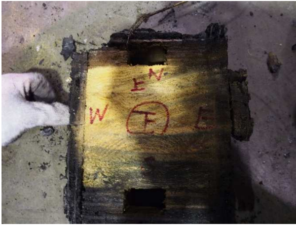
写真 2.3.4-9 柱下部の炭化状況
