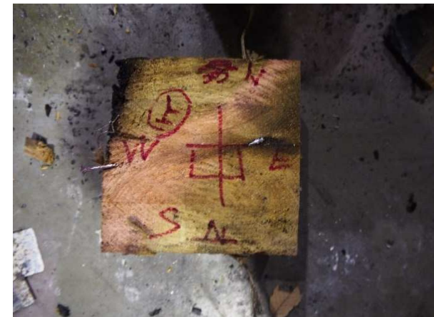
写真2.3.4-8 柱中部の炭化状況
