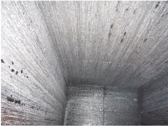
図 3-①-51 内部炭化状況
