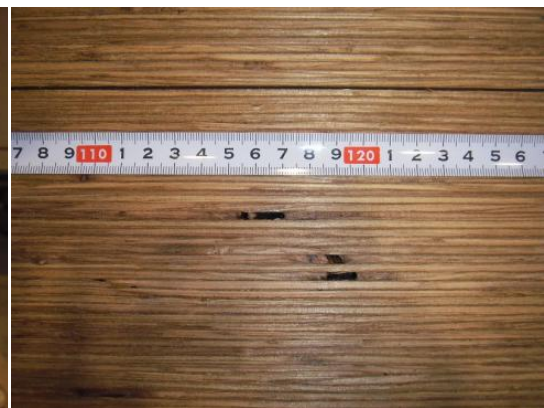
図 3-①-43 節の状況（裏に抜けてはいない）
