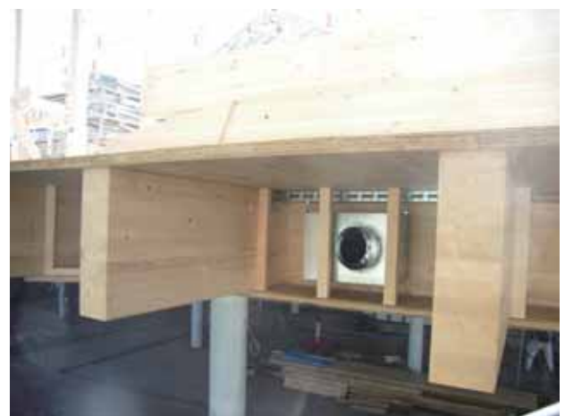
ウェブを貫通する空調用ダクト
