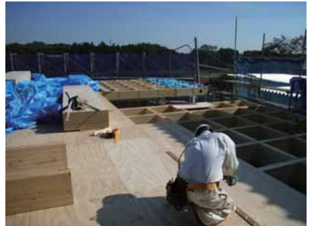
ピッチが一定となるよう、合板で作成した定規を用いて上面のフランジ LVL 面材をビス留め
